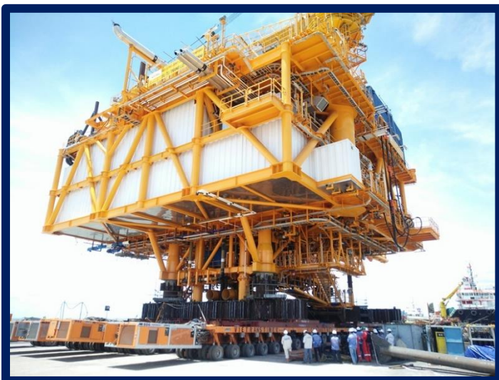
Vận chuyển và hạ thủy thành công kiện Topside ST-LQ nặng ~2.600 tấn từ vị trí chế tạo xưởng sà lan tại Cảng PVC-MS, Vũng Tàu.
